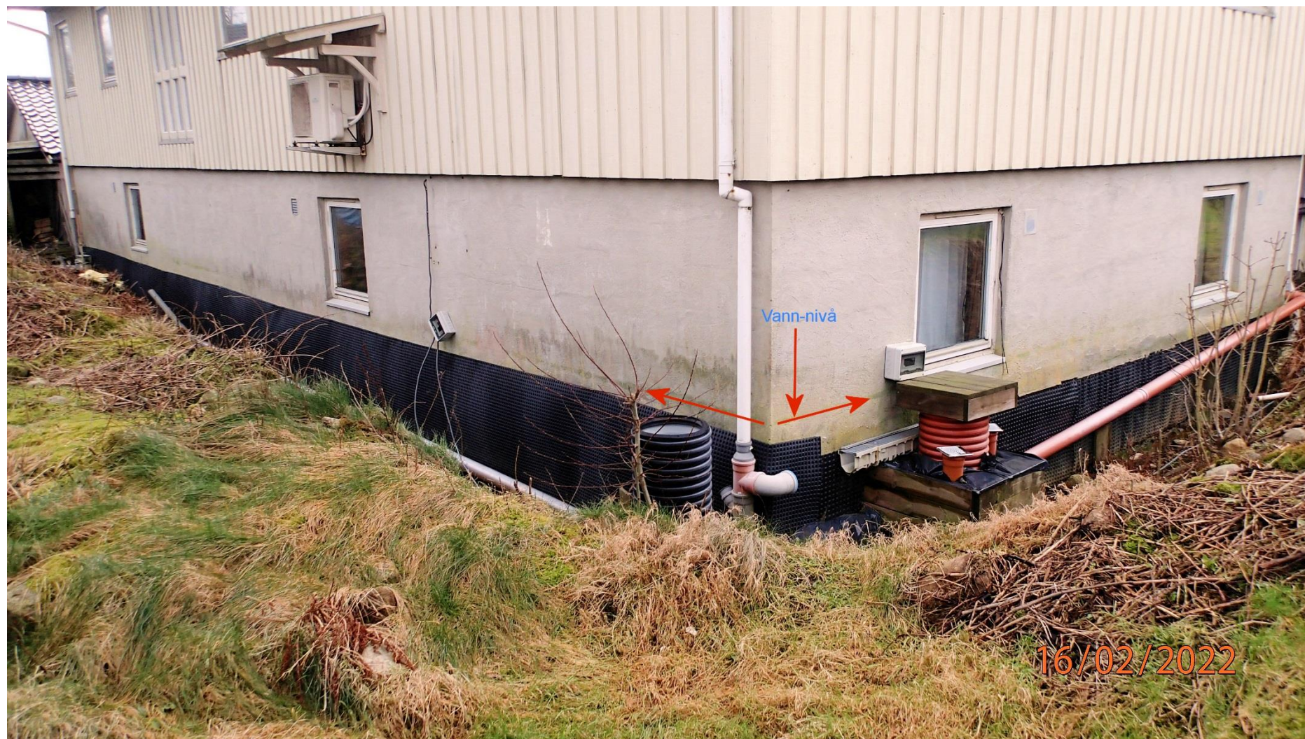
Kaneheia 38 – Vann-nivå ved siste inntrenging i kjeller – etter dette har vi ikke kunne bruke kjelleren. Pumpe ble da montert.
